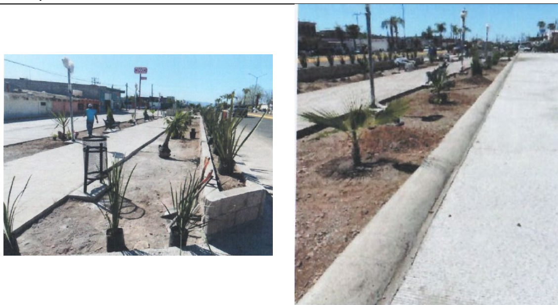
Figura 5. Reporte fotográfico de la obra de rehabilitación del sistema de agua potable y alcantarillado, así como pavimentación de la calle lateral derecha del boulevard Maximiliano Silerio Esparza, Rodeo, 2023
